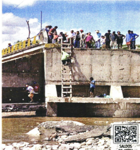
AISLADOS. El puente que conecta a Ajuchitlán con San Miguel Totolapan, en Guerrero, se derrumbó y dejó aisladas a varias comunidades.
